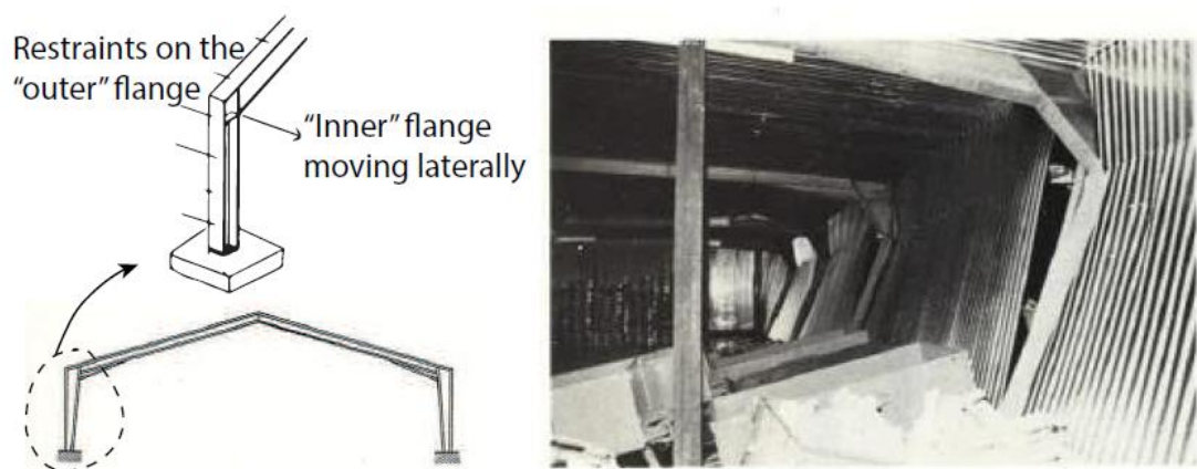
Figur 2. Kollaps av lagerbyggnad på grund av otillräcklig stagning i ramhörn. (Johannesson et al. [4])
